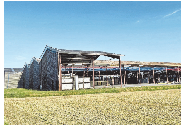
Op de grote hallen voor houtopslag liggen zonnepanelen. Door de koperdiefstal functioneert geen enkele meer in Deerlijk. Foto LSI
